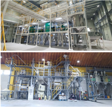
APC & 종자정선설비 설계·시공
